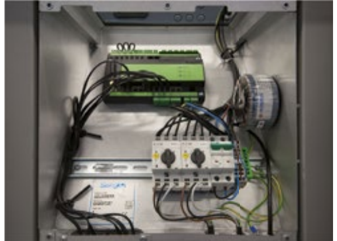
Tous les composants électriques et l'électronique de commande sont installés dans une armoire spéciale située dans le module central.
